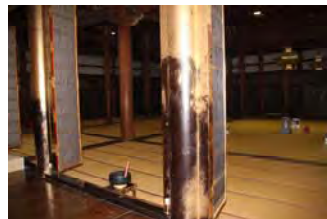
【内陣丸柱は金箔の剥落が著しい】
