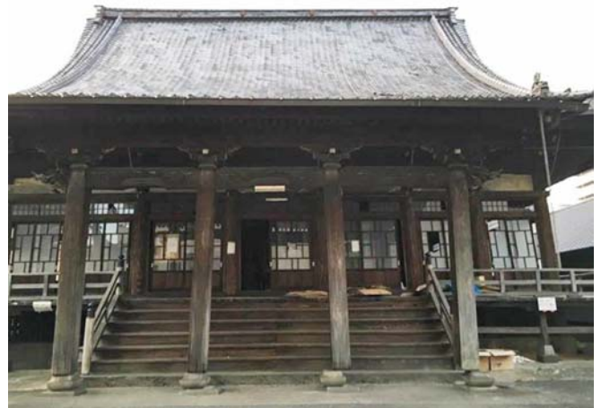
被災直後の熊本教務所本堂(柱が傾き倒壊寸前の様子)
